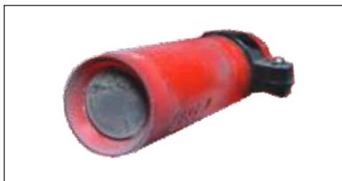
Verschmutzte Photozelle, welche einen Fehler bei der Zündung oder den Fehler des Schwundes der Flamme verursachen kann.
